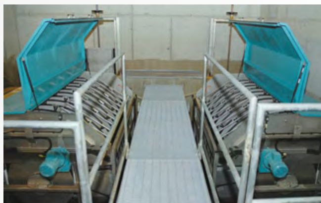
Очистные сооружения Граведона, Италия, 10FDB
