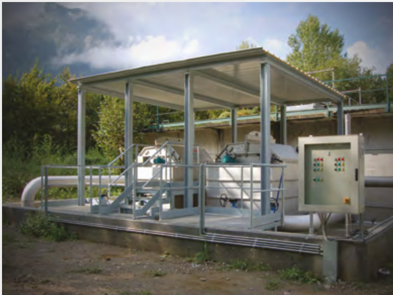
Очистные сооружения Карлаццо, Италия, 6FDO
