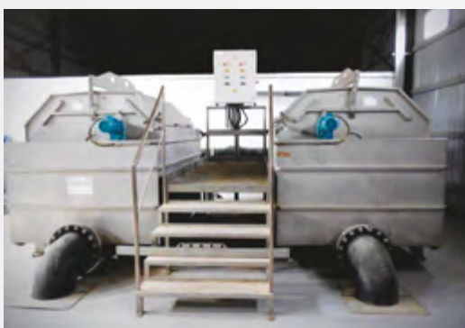
Очистные сооружения промышленный город Аль-Хардж, Саудовская Аравия, 8FDO_атип
